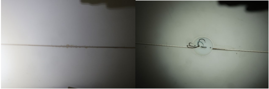
Kuva 29. ja 30. Toisen makuuhuoneen katossa on jälkiä kattovuodosta.
