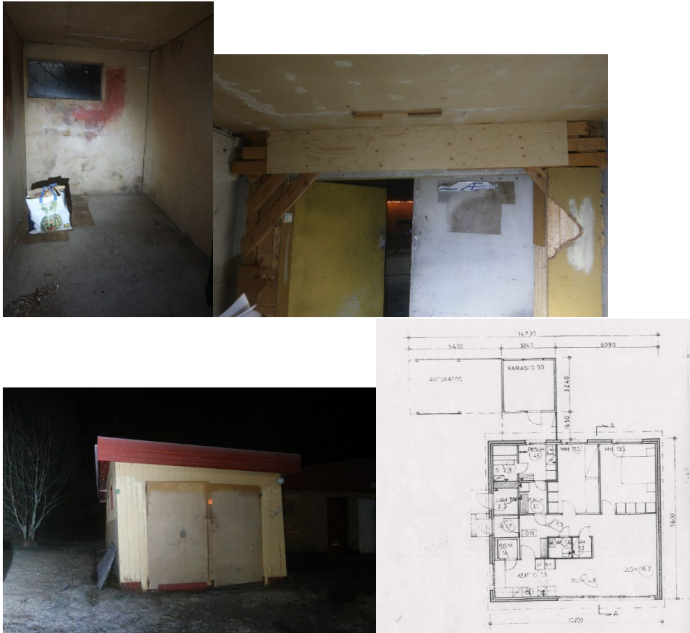
Kuva 31. 32. 33. ja 34. Rakennuksen yhteydessä on autotalli/varastorakennus, joka on kylmää tilaa. Rakennus on painunut vinoon. Rakennetta on tuettu tallin oven päälle tehdyllä tukirakenteella. Rakennus on lupakuivissa autokatos ja varasto. Mahdollisesta muutosrakennusluvasta ei ole tietoa. Suosittelaa purkamaan/ uusimaan autotallirakennus.
